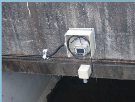
水位センサー設置状況
